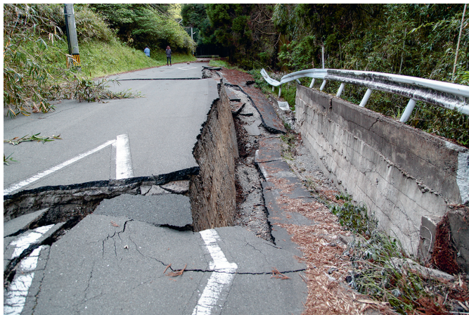
Effondrement d'une route suite à la série de séismes de Kumamoto en avril 2016 © amata90 / Shutterstock
